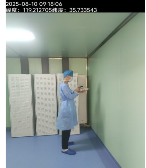
西墙外设备间
